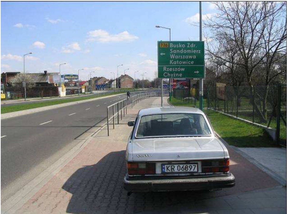
Rysunek 1. Nieprawidłowo zaprojektowany zjazd na przecięciu DDR - obniżenie niwelety DDR w miejscu zjazdu z zachowaniem nawierzchni zjazdu
