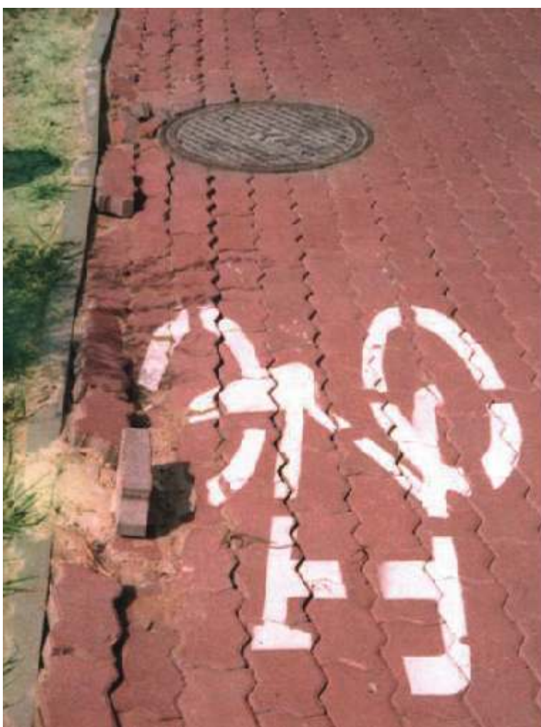
ŹLE: kostka betonowa faluje i rozjeżdża się już w miesiąc po oddaniu do użytku (Warszawa, ul. Rembielińska).
